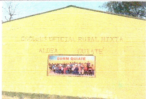
Foto 4: PINTURA DE INTERIORES Y EXTERIORES EN MAL ESTADO
